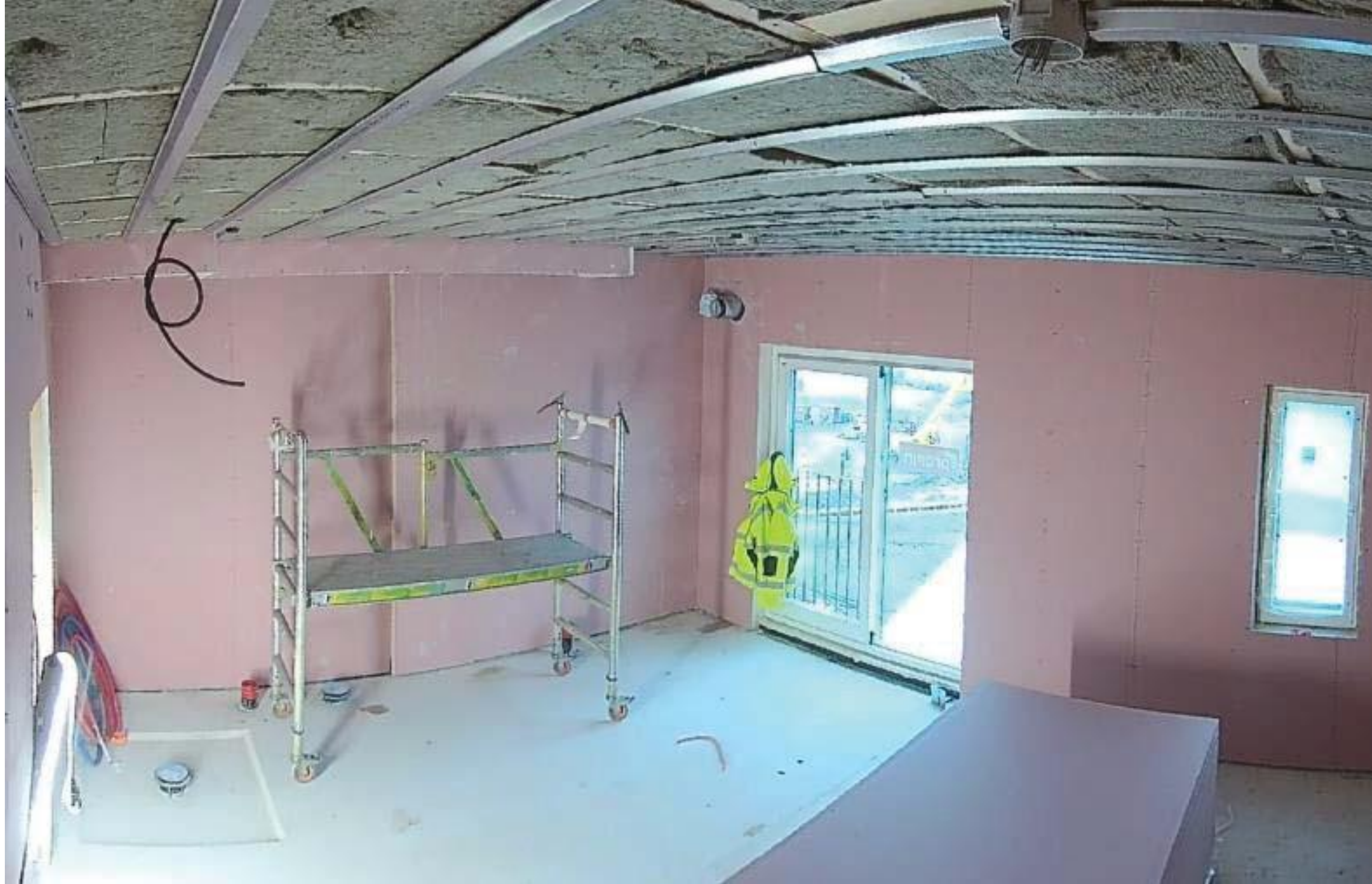
Kipsiverhoukset ja koteloinnit huoneistossa valmiina, katossa puuranka ja ääneneristeenä mineraalivilla, sekä jousirangat asennettuna. (Kuva: TTS – Työtehoseura)
