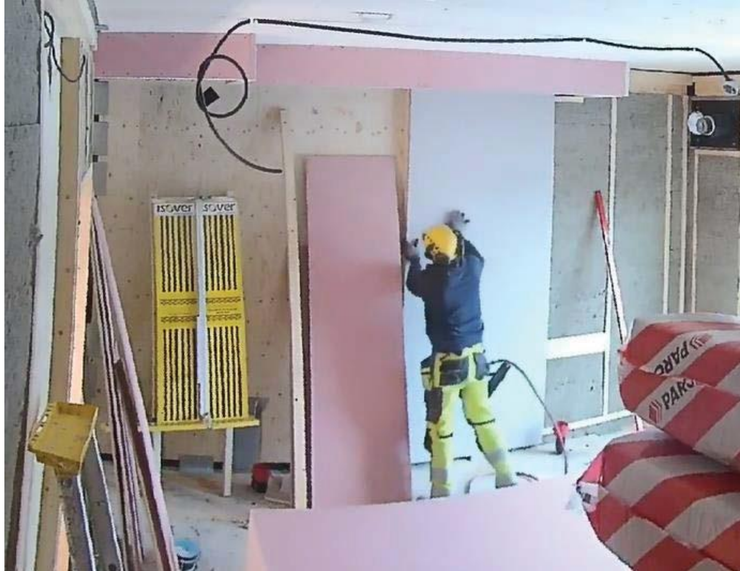
Sisäverhouslevyn asennus. Lämmöneristettä vasten oleva levy on N-luokan 13 mm kipsilevyä, pintalevy on 15 mm paksuista palokipsilevyä. (Kuva: TTS – Työtehoseura)
